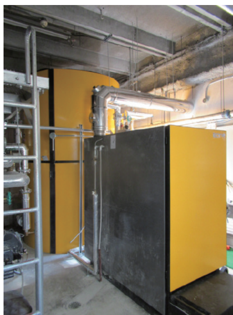
▲写真④ ETA130kW チップボイラー (富士大学学生寮)
